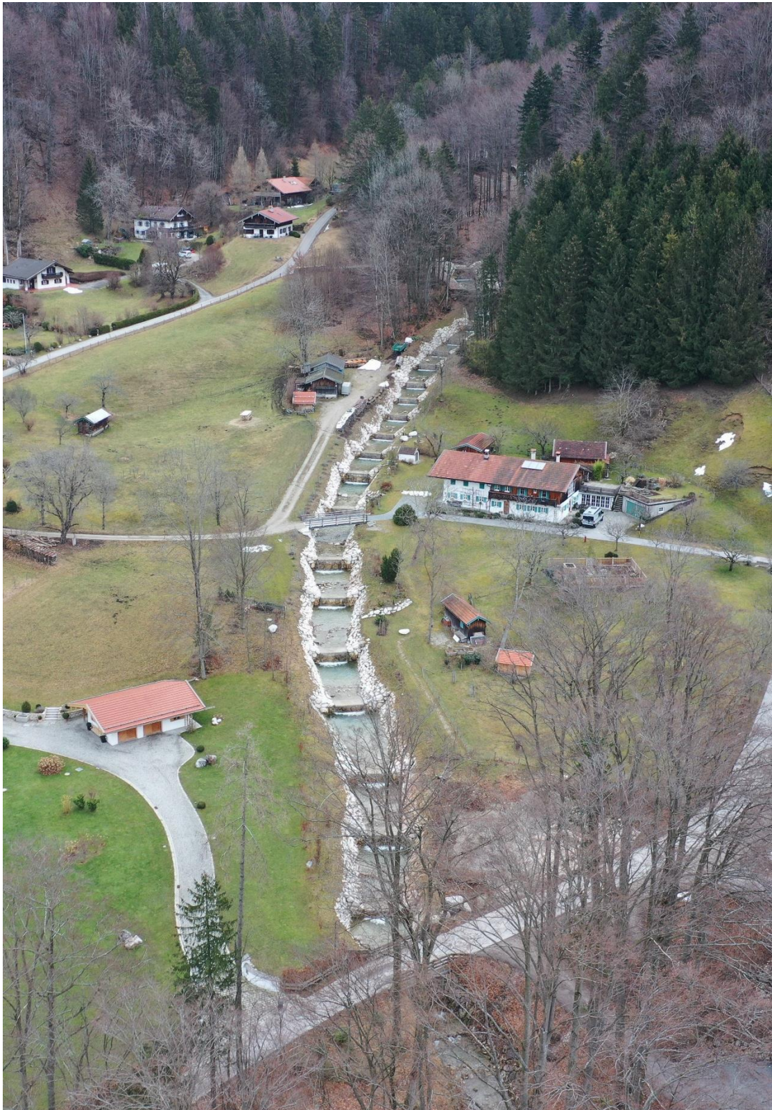
Abbildung 2: Sanierte Sperrenstaffelung Lochgraben oberstrom Brücke Amselweg. Im Hintergrund ist die sanierte Geschleiberückhaltesperre zu erkennen. Blick von Westen.
