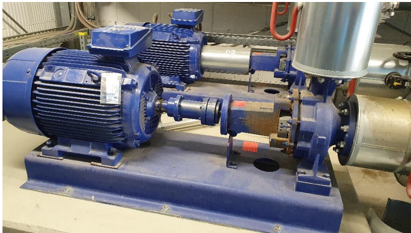
Netzpumpen der Fa. KSB
